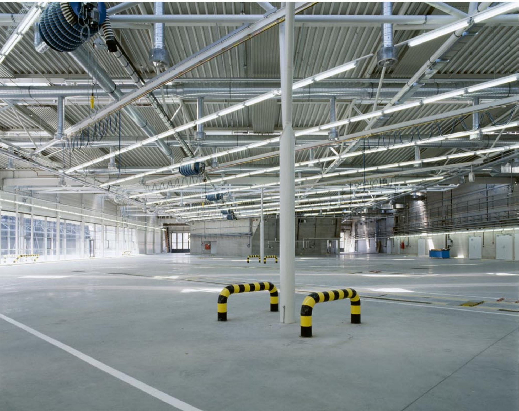
über ein vom tragwerk abgehängtes energie- gondelsystem ist die versorgung der arbeits- plätze mit strom, druckluft und licht ohne am boden liegende kabel gewährleistet.
